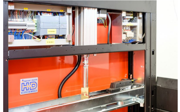
Ansteuerung aller Funktionen über eine Siemens S7-1200
